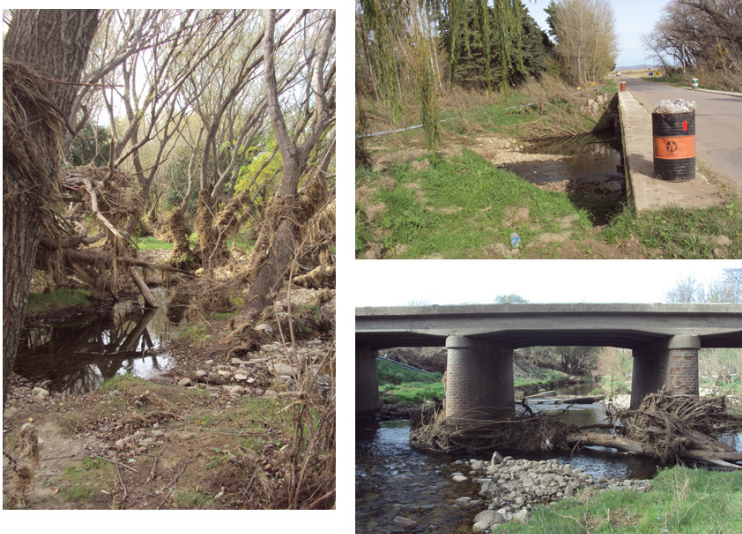
Figura N° 6. Daños ocasionados por la crecida (17/03/2015)
