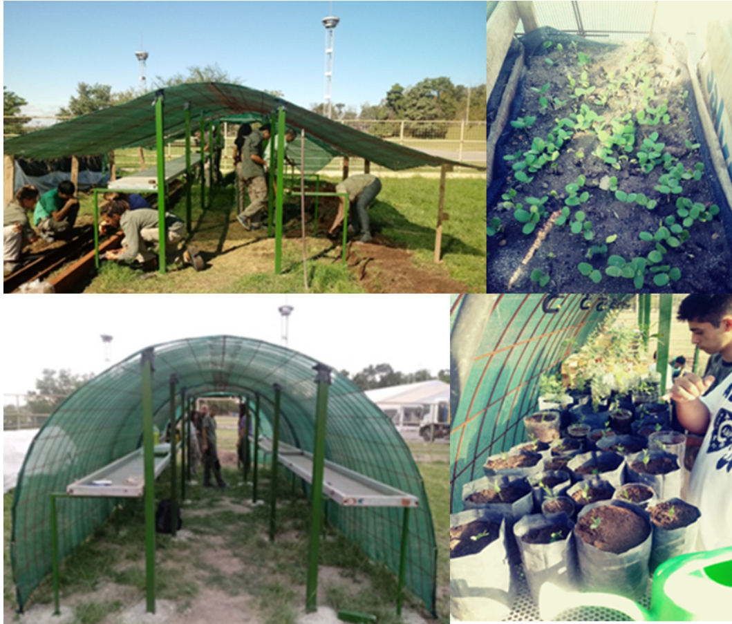
Figura 2: Construcción de umbráculo, en conjunto con docente y estudiantes de la Práctica Profesionalizante III (año 2018).
